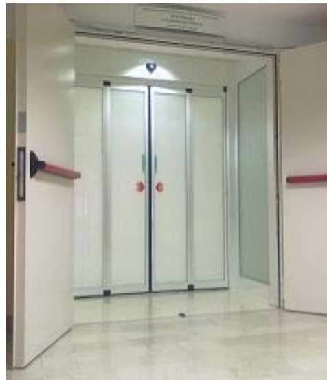
Fig. 7.2 - Doppia porta all'ingresso del reparto: porta REI e porta automatica
